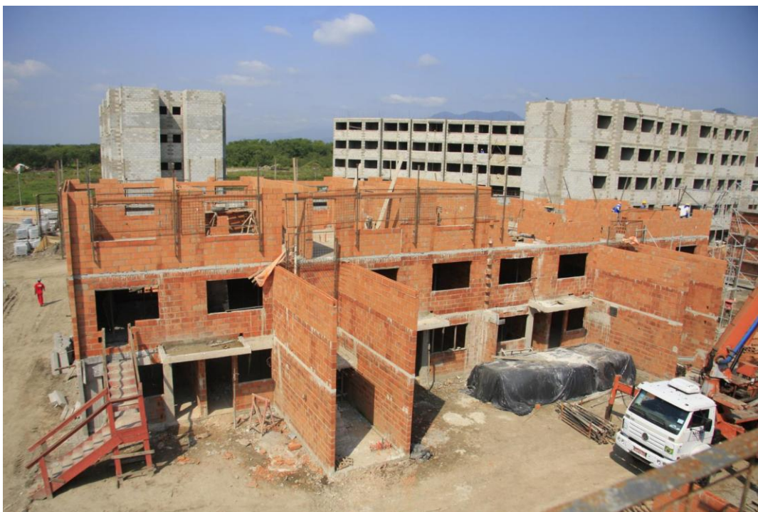
Figura 2.9.1 Edifícios com blocos de concreto e cerâmicos. Fonte: Deangelo Fotos: RUBENS LARA. Disponível em: http://deangelofotos.blogspot.com.br/2010/11/rubens-lara.html . Acesso em 02/05/2012.
