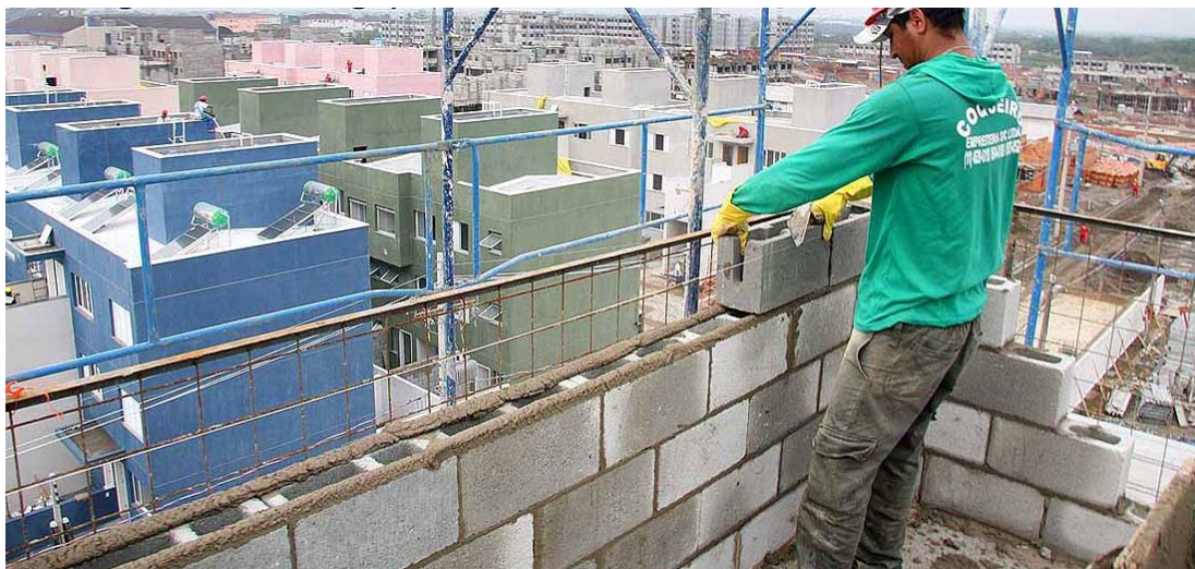
Figura 2.9.5 Execução da alvenaria estrutural. Fonte: Deangelo Fotos: RUBENS LARA 30-07-2010. Disponível em: http://deangelofotos.blogspot.com.br/2010/07/rubens-lara-30-07-2010.html . Acesso em 02/05/2012.
