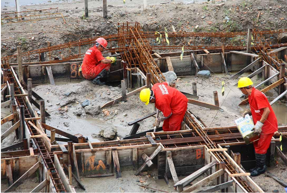
Figura 2.9.10 Concretagem de elementos de fundação. Fonte: Deangelo Fotos: RUBENS LARA 30-07-2010. Disponível em: http://deangelofotos.blogspot.com.br/2010/07/rubens-lara-30-07-2010.html . Acesso em 02/05/2012.
