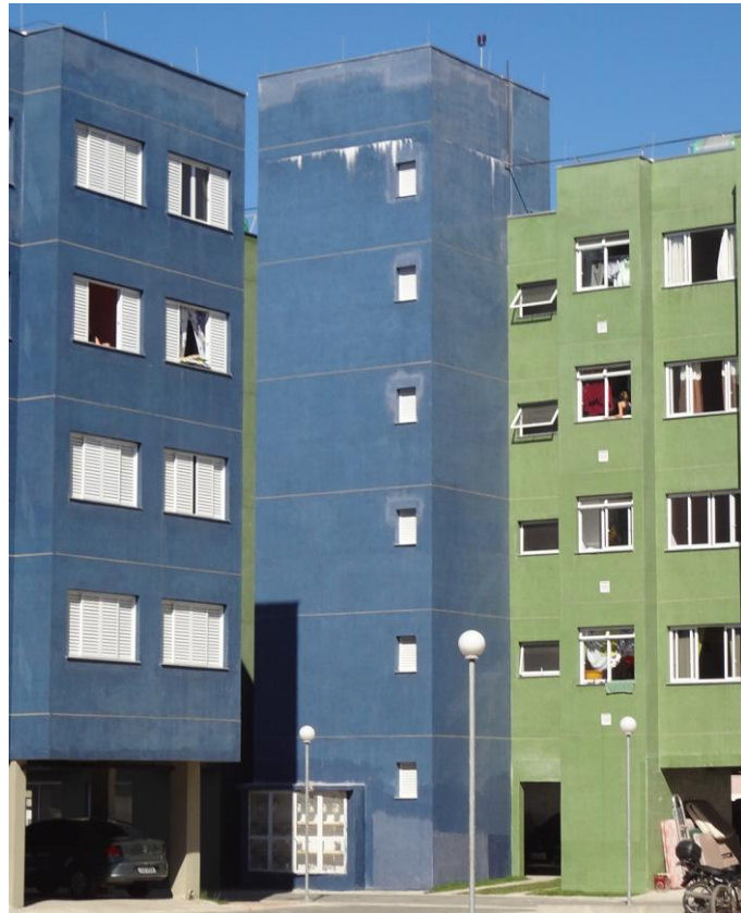
Figura 2.9.13 Patologias no revestimento em pastilha de vidro. Fonte: Erica Lemos Gil
