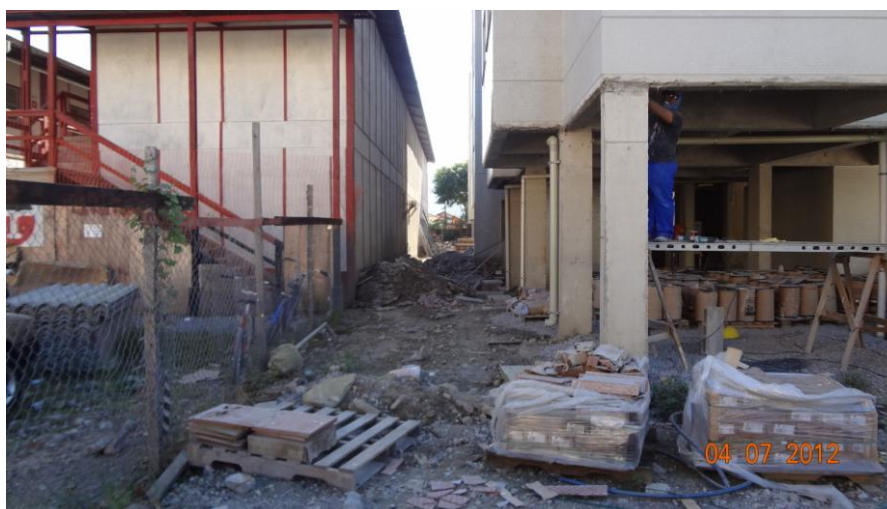
Figura 2.9.18 Armazenamento de materiais em piso desnivelado. Fonte: Erica Lemos Gil
