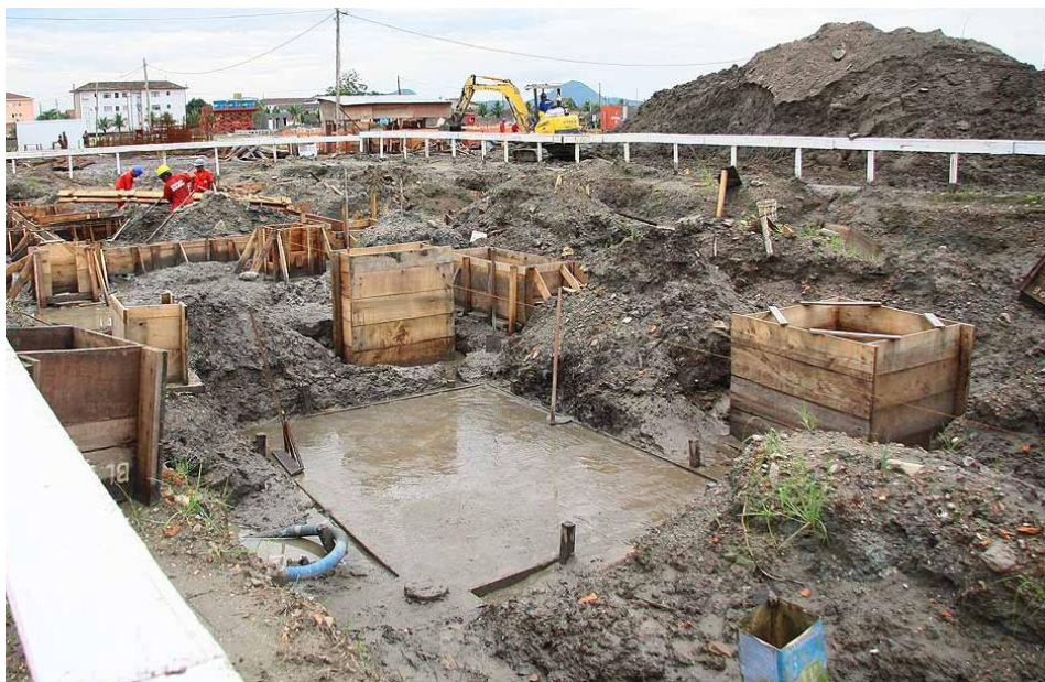
Figura 2.9.11 Concretagem de elementos de fundação. Fonte: Deangelo Fotos: RUBENS LARA 30-07-2010. Disponível em: http://deangelofotos.blogspot.com.br/2010/07/rubens-lara-30-07-2010.html . Acesso em 02/05/2012.
