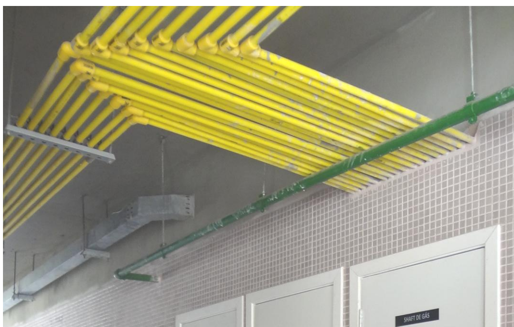
Figura 2.8.6 Tubulações de gás PPR e acesso às instalações de gás no pavimento térreo. Foto Erica
