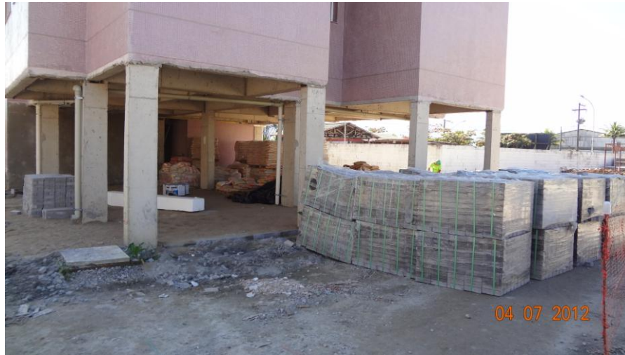
Figura 2.9.19 Armazenamento de materiais em piso desnivelado. Fonte: Erica Lemos Gil
